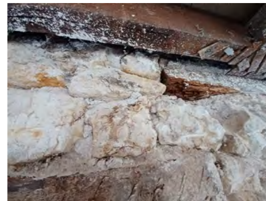
Champignon sur maçonnerie
