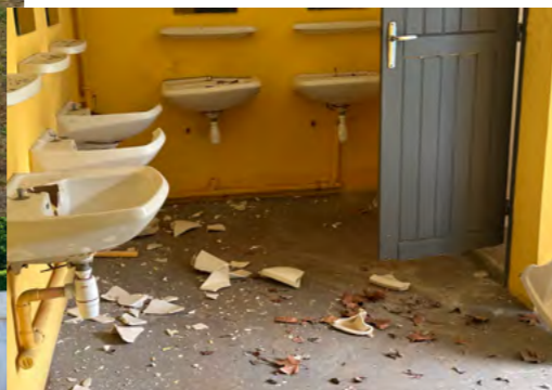
Vandalisme et dégradations au camping de Langeais
